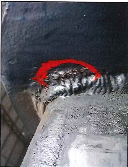
Local: Spreader Item # 19: viga "T" do spreader apresentava pequena trinca na união com a asa do spreader. Status: corrigido .
